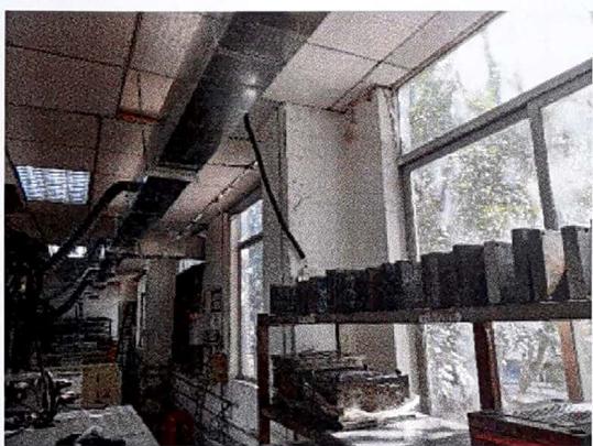
车间收集管道
